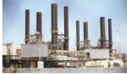
محطة توليد الكهرباء في غزة
