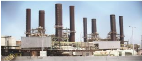
محطة توليد الكهرباء في غزة
